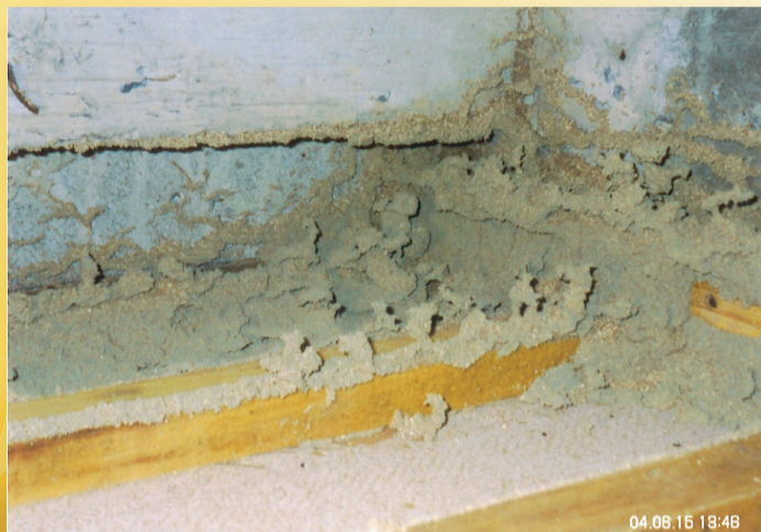
【写真説明】イエシロアリの蟻道。家屋の床下に構築され、この中を通路として喰害活動を続けている。
